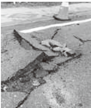
▲ゆがみにより損傷した道路（安平町）
