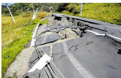
平成 15 年十勝沖地震（豊頃町）
